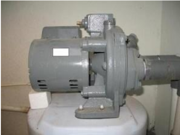
Gambar 1. Mesin Pompa Air
